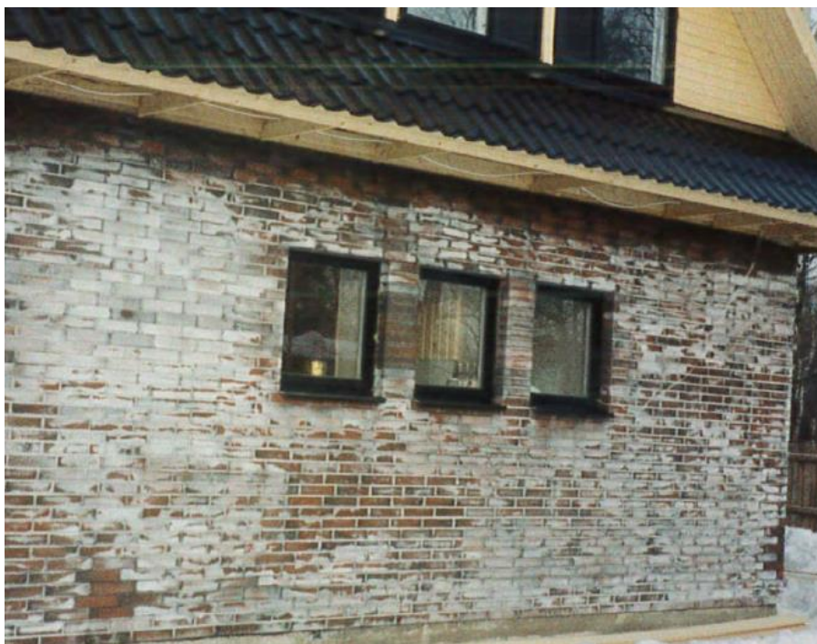
Рис. 1. Высолы на фасаде частного дома. Фото концерна Wienerberger Group
