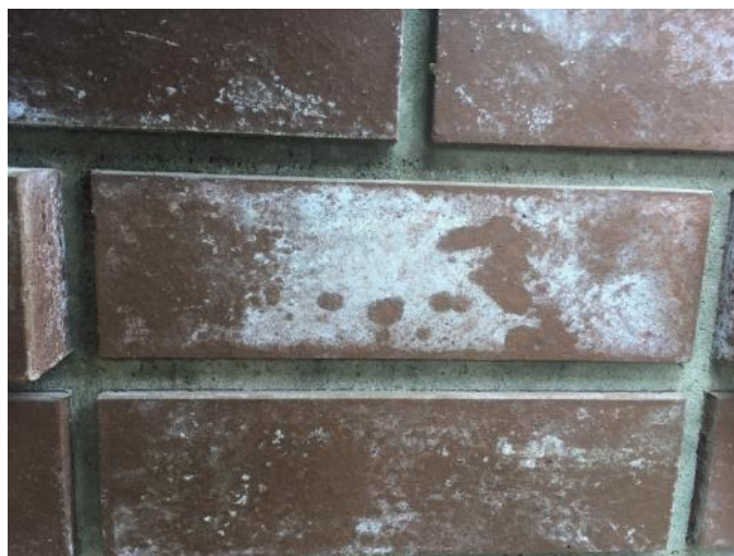
Рис. 4. Кристаллы солей на поверхности керамической плитки.
