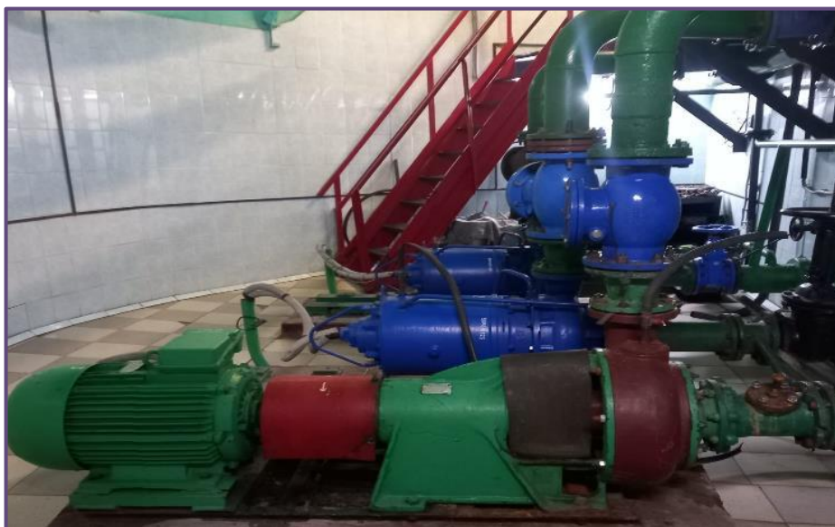
Рис. 1 Машинный зал канализационной насосной станции
