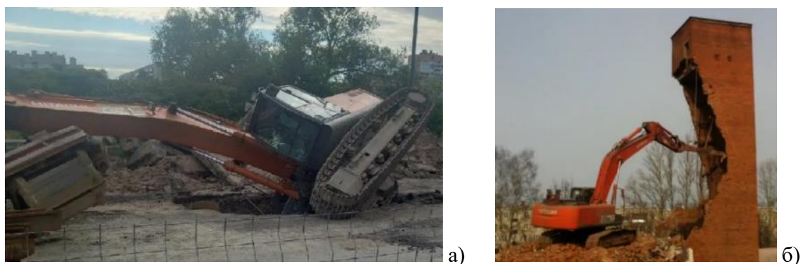
Рис. 1. Примеры последствий нарушений, допущенных при разработке проектной документации по сносу здания: а) провал экскаватора в подвал здания; б) вероятность обрушения здания на экскаватор и машиниста при нарушении технологии работ
