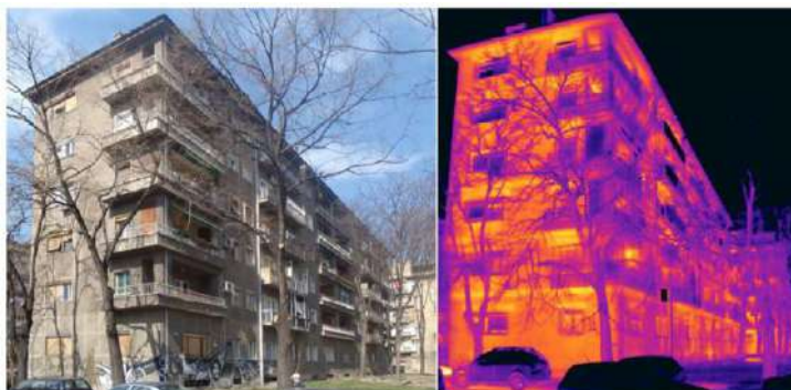
Рис. 1. Инфракрасное изображение кирпичного здания – Белград
