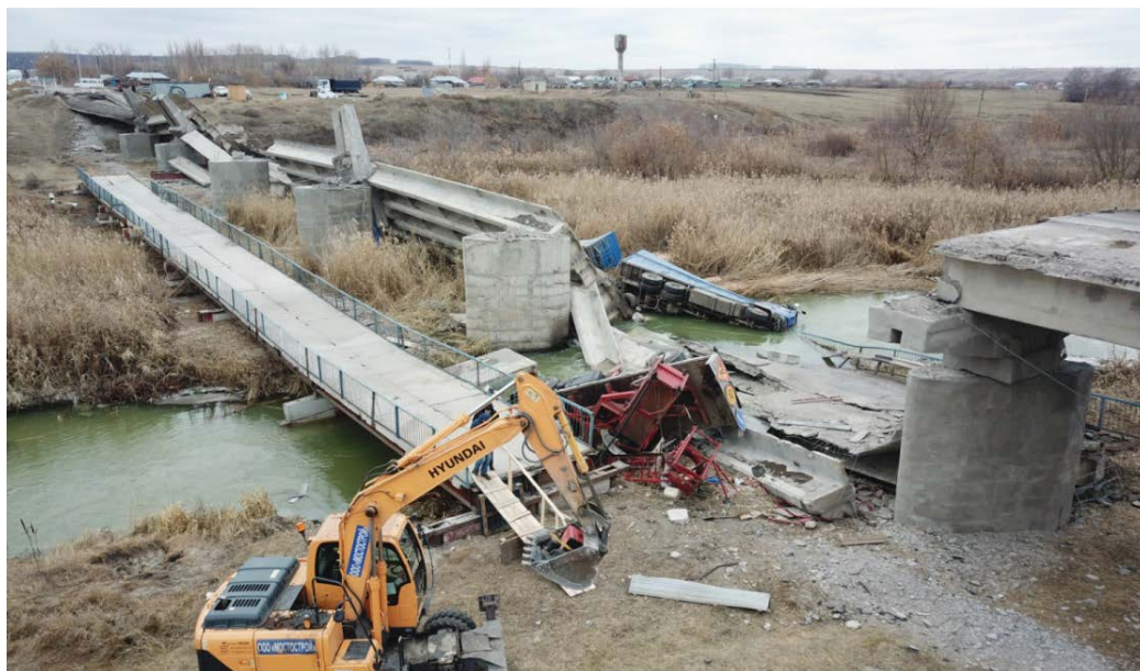
Рис. 1. Фото обрушившегося мостового перехода (из открытых источников)
