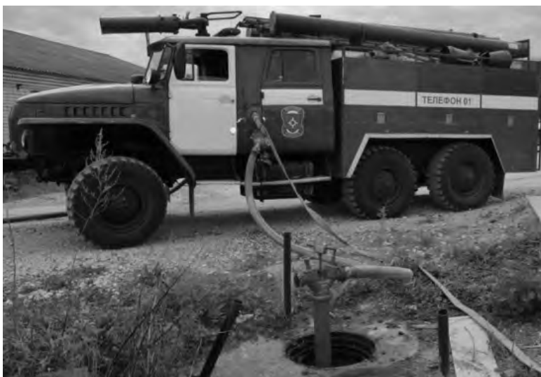
Рис. 1. Расположение гидранта и насосного устройства
