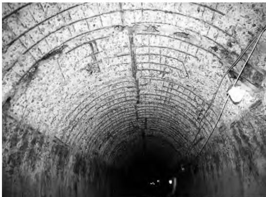
Рис. 2. Техническое состояние подводящего канала к ЛОС до реконструкции
