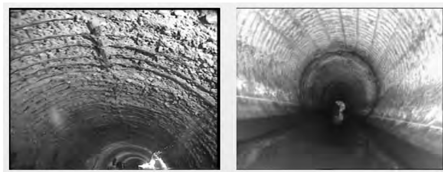
Рис. 1. Газовая коррозия железобетонного трубопровода, обнажение арматуры
