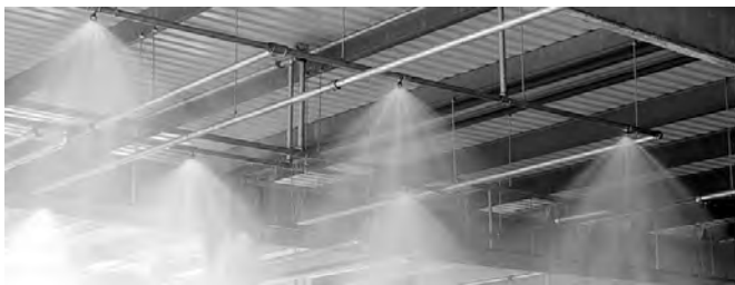
Рис. 4. Работа системы автоматического пожаротушения
