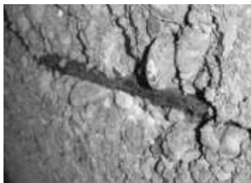
Рис.1. Разрушение конструкций под действием влаги
