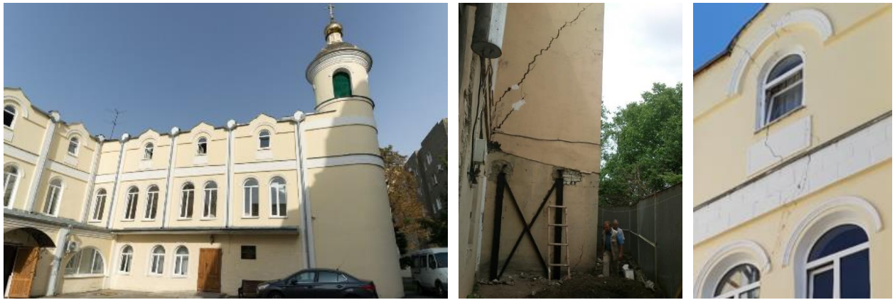
Рис. 4. Общий вид и деформации здания Духовной Семинарии
