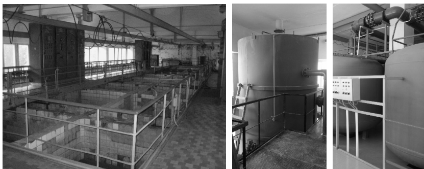
Рис. 1. Сооружения станций обезжелезивания (слева направо): фильтры (станция № 1); биореактор БСВЭ и фильтр ФПЗ-1 (станция № 2)
