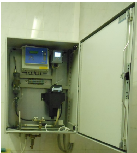
Рис. 5. Система автоматического контроля качества воды на распределительной сети, установленная в одном из зданий Москвы и позволяющая оценить качество воды по наиболее индикаторным для потребителей показателям – это мутность и остаточный хлор.
