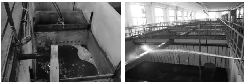
Рис. 1. Водопроводная очистная станция (слева направо): смеситель и скорый фильтр
