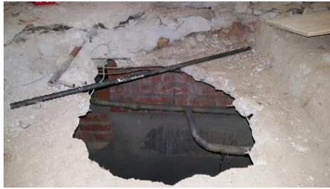
Рис. 1. Фрагмент одной из поврежденных плит на объекте
