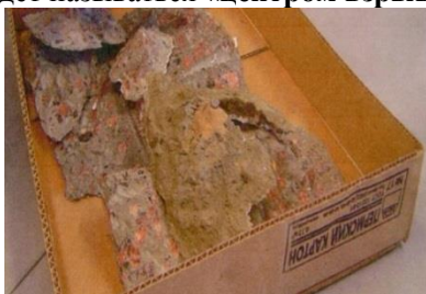
Рис. 2. Куски бетона, отколовшихся от колонн ж/б балок в торговом центре «МЕТРО» г. Москвы.
