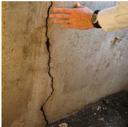
Рис. 1. Сквозные трещины в стене
