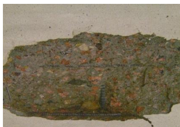
Рис. 3. Светло-коричневое пятно на поверхности ж/б панели - концентратор напряжений в бетоне.
