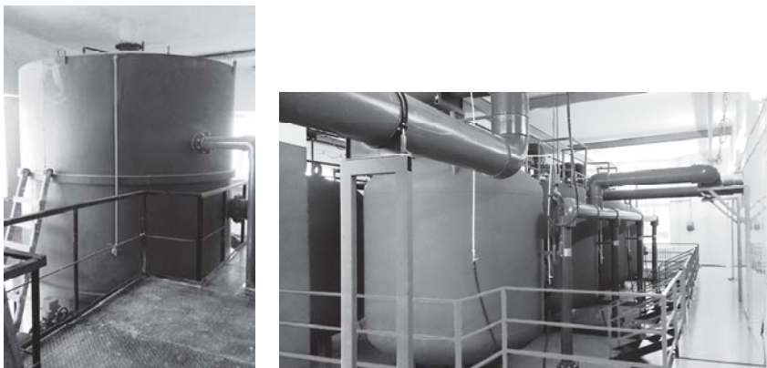
Рис. 1. Общий вид станции обезжелезивания
