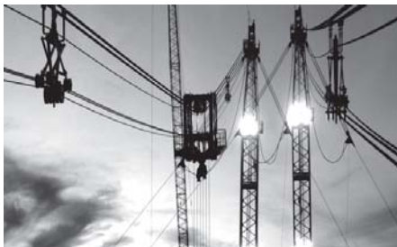
Рис. 6. Опоры кабельного крана
