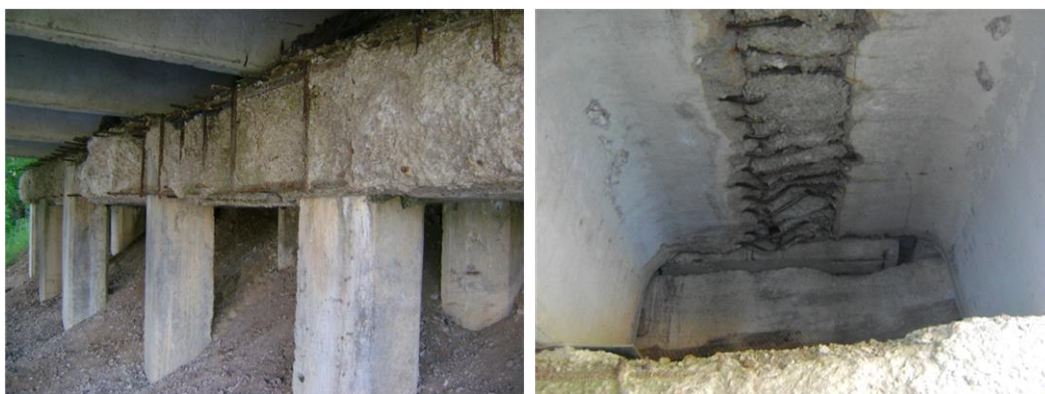
Рис. 2,3. Разрушение железобетонных конструкций (повреждение бетона и арматуры).
