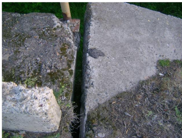
Рис.1. Разрушение железобетонных конструкций
