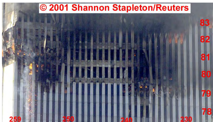
Рис.2. Повреждения огнезащиты колонн наружной оболочки Южной башни (ВТЦ-2) после удара самолёта и взрыва топлива во время событий 11 сентября 2001 года
