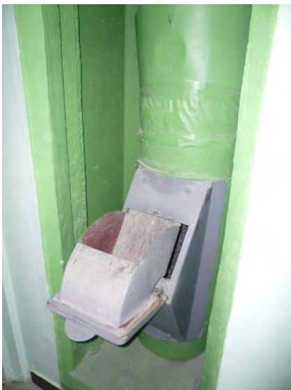
Рис. 1. Сухой холодный мусоропровод в здании
